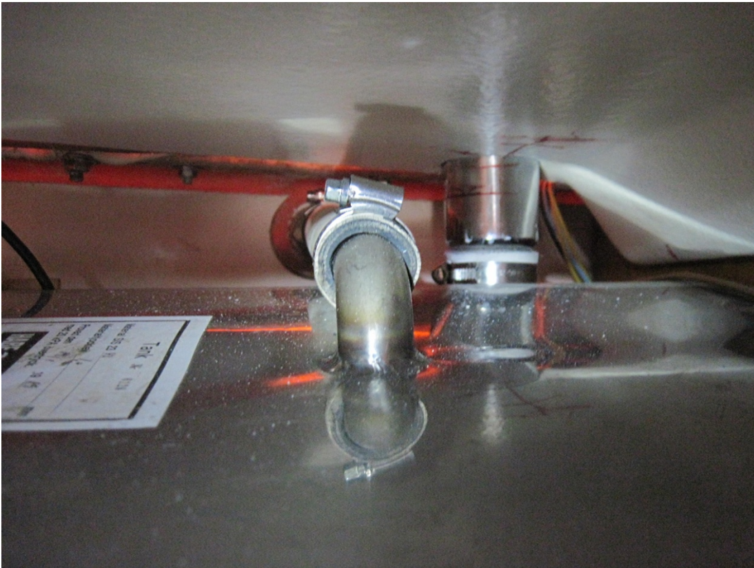
Septitanken återmonterad med nya slangar.
